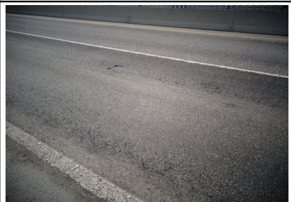
S15 망상균열 및 소성변형 (양평방향)
