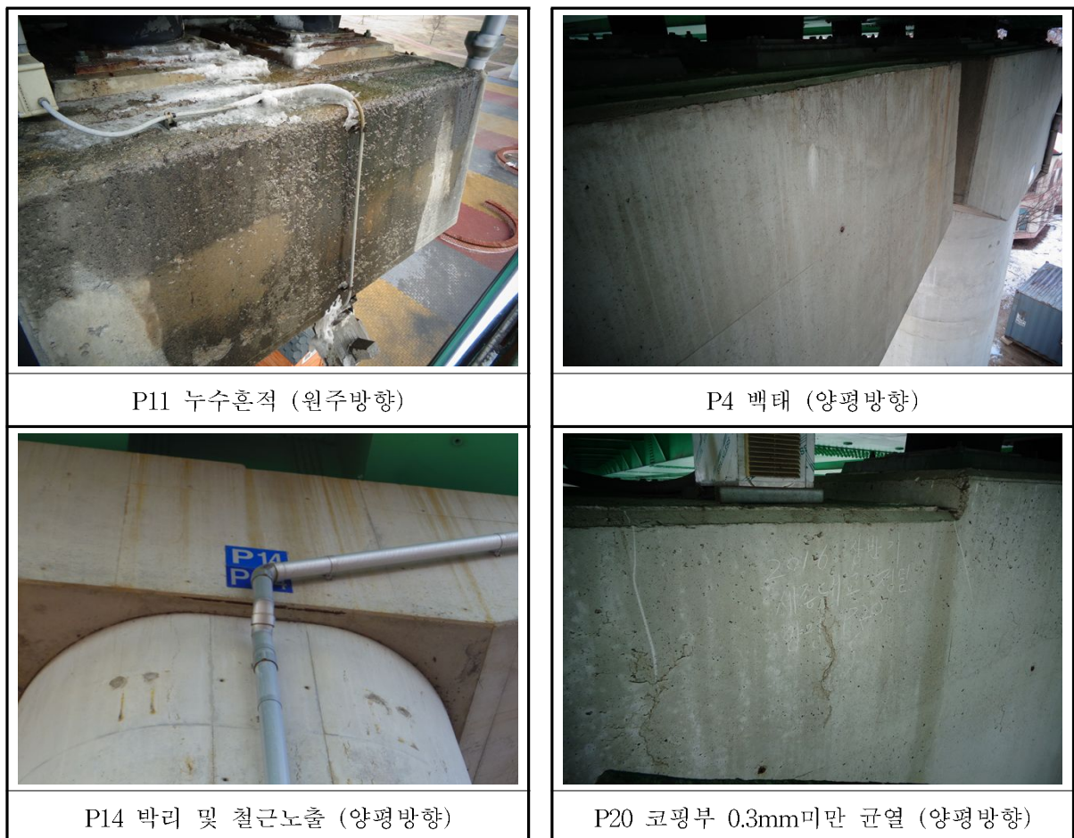
【그림 3.14】 교각 손상 현황
