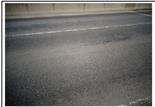
S5 아스콘 균열 (원주방향)
