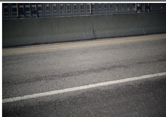
S9 아스콘 균열 (양평방향)
