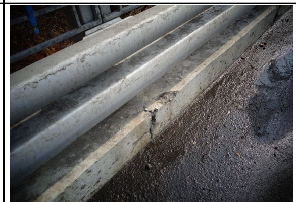
S32 연석 파손 (양평방향)
