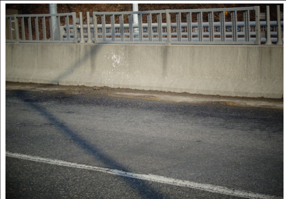
S32 망상균열 및 소성변형 (원주방향)
