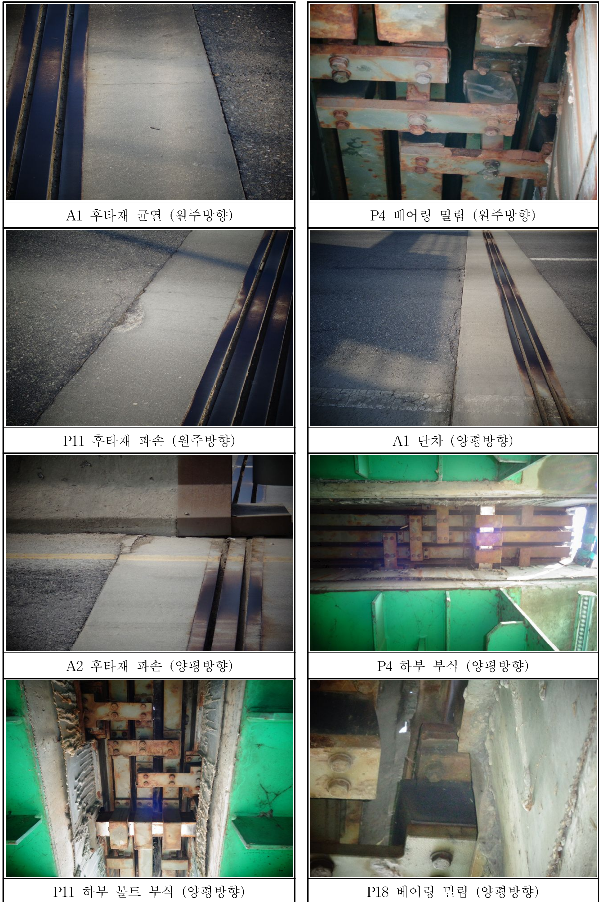
【그림 3.17】 신축이음장치 손상 현황
